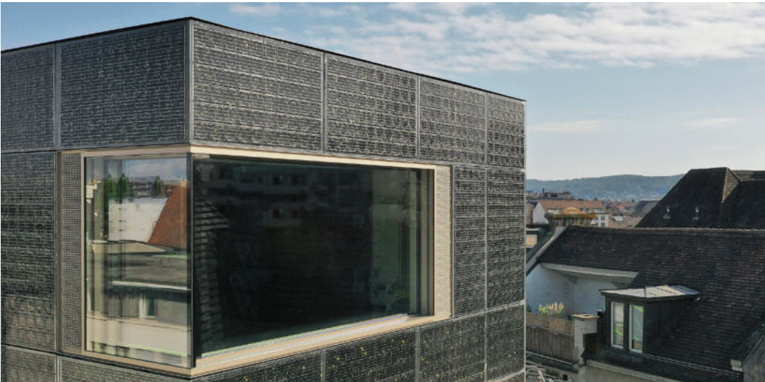
Abb. 93 | Photovoltaik als Gestaltungsmittel
