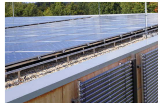
Abb. 67 | horizontal installierte PV-Module
