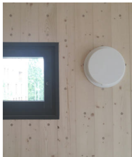
Abb. 110 | dezentrales Lüftungsgerät mit integrierter Wärmerückgewinnung
